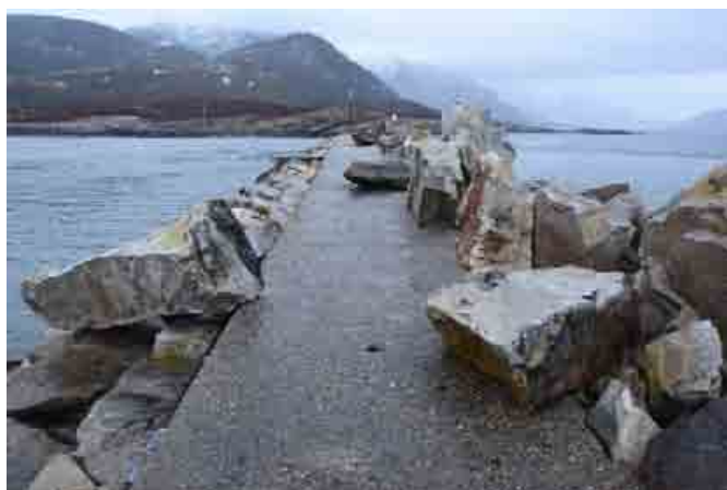
Skader på brystning
