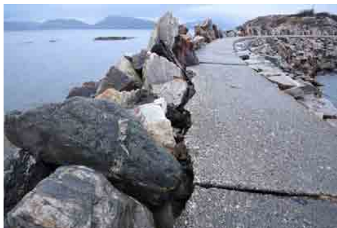
Skader med sannsynlig setning i steinmasser på utside av molo.
